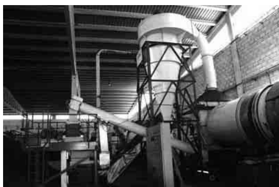
Foto 5. El producto compostado y estabilizado, con la humedad ajustada, se peletiza para compactarlo y formar el gránulo de pelet.
